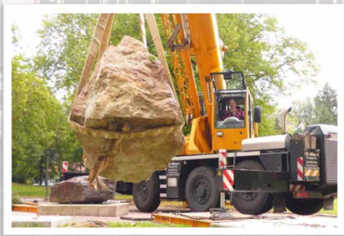
- Der Autokran der Fa. Alborn platziert präzise den Dolomit-Erzbrocken auf das Fundament
